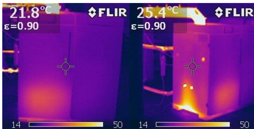
Rys. 69. Przykładowe zdjęcia termowizyjne obudowy kotła EG-PELLET
