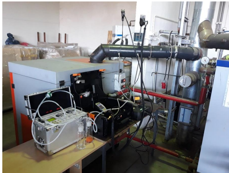
Rys. 26. Widok króćców pomiarowych w przewodzie kominowym wraz z sondami aspiratora, pyłomierza i analizatora spalin
