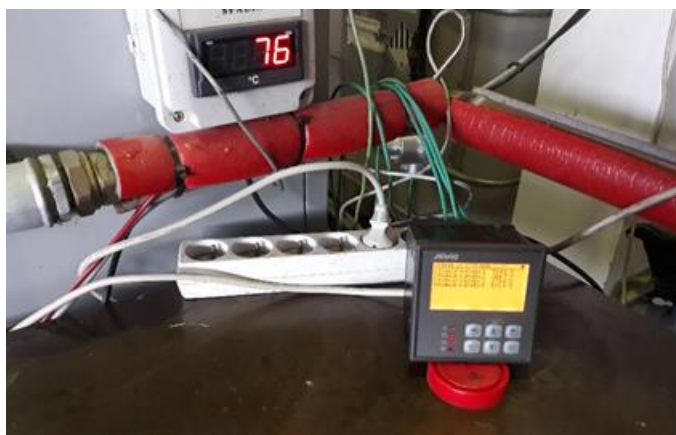
Rys. 28. Widok czterokanałowego rejestratora danych (APAR AR205)
