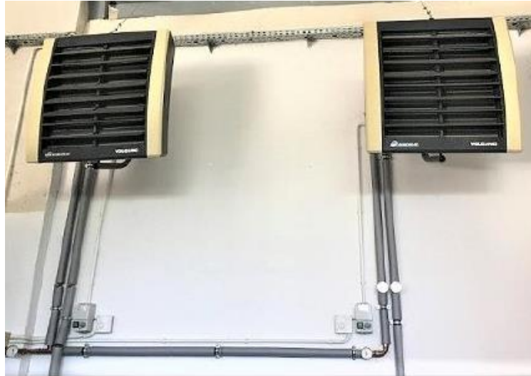
Rys. 25. Widok nagrzewnic wentylatorowych układu obioru ciepła
